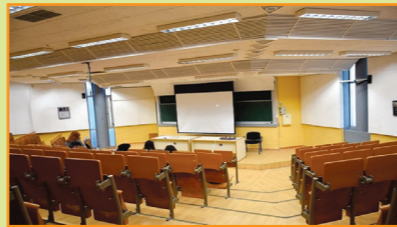
Αναβάθμιση - Συντήρηση, κλιματισμός και ανακαίνιση αμφιθεάτρων Σχολής Θετικών Επιστημών και Πολυτεχνικής Σχολής
